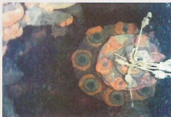
「マンボウ型」が撮影した3号機の原子炉格納容器内部。設備の損傷状況などが分かった
