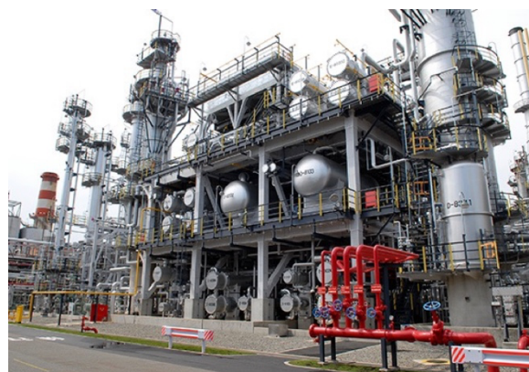
図 1 石油精製プラント (ENEOS 株式会社)
